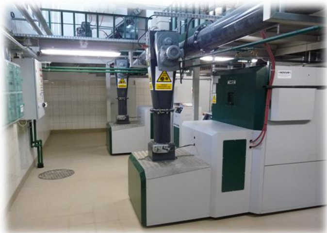
Centralny system ciepłowniczy w Maniowach
